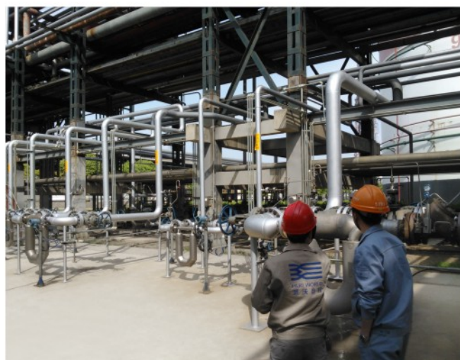
中石化长城能源化工(宁夏)有限公司 (宁东能源煤化工基地)-控制阀
