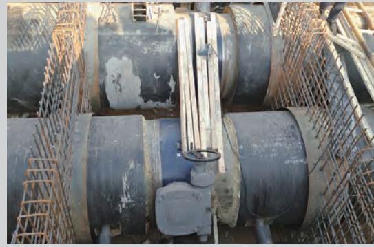
潍坊民生热电DN1400管线及支线阀门 (2015-2016年)
