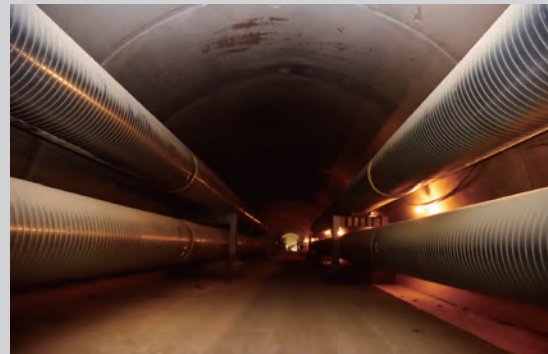
太原热力“太古项目”(在建) DN1400管线工程及泵站电动阀门
